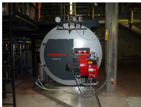
Dampfkessel 1 nach erfolgreicher Inbetriebnahme
