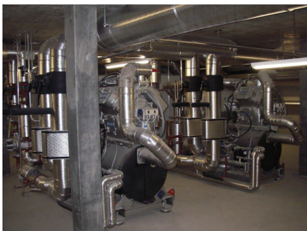
Die beiden NH 3 -Grundwasser-Wärmepumpen
