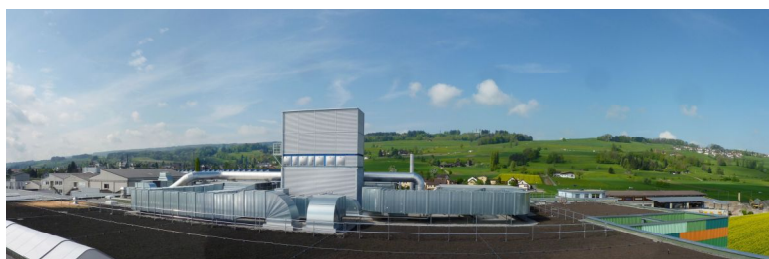
Lüftungsanlagen installiert auf dem Dach
