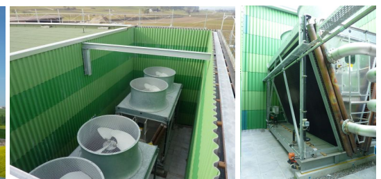
zwei Nasskühltürme à je 1.8 MW
