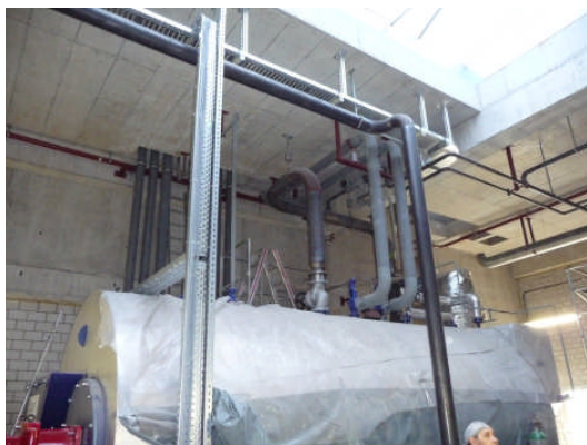
Neuer Hochdruck-Dampfkessel 8 t/h (5.2MW)
