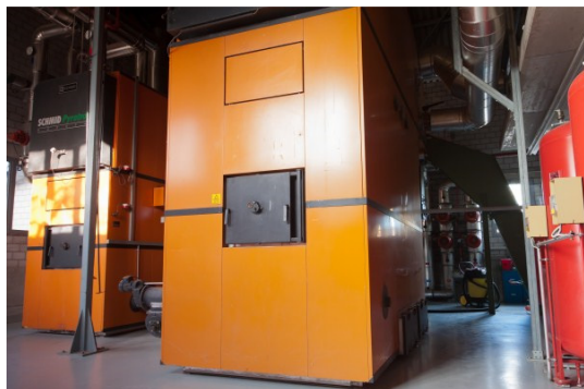
Holzschntzelkessel 1x 900 kW, 1 x 2'400 kW
