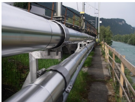
Fernleitung entlang Rheinviadukt
